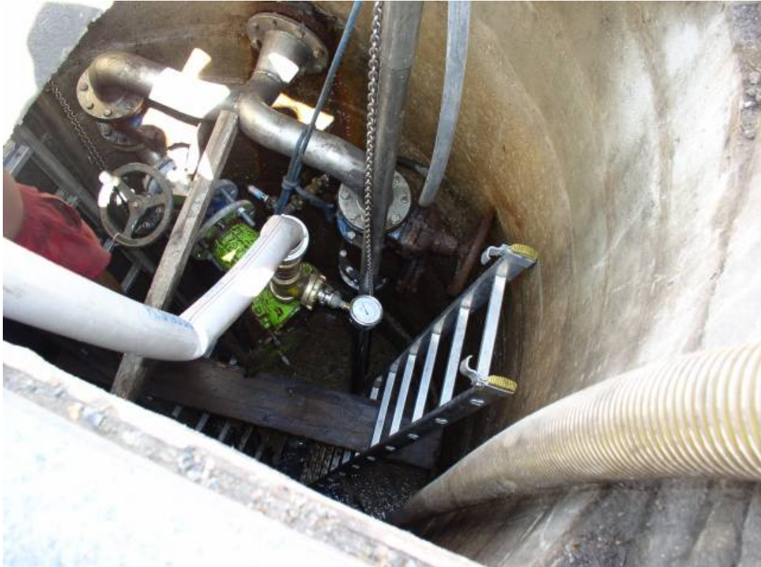
Abbildung 11: Pumpenschacht mit installierter Schleuse für Molch bei PW Seebad Illmitz AWW Seewinkel
