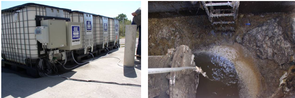
Abbildung 29: Dosiereinrichtung für Nutriox Pumpwerk Donnerskirchen RHV NSW
