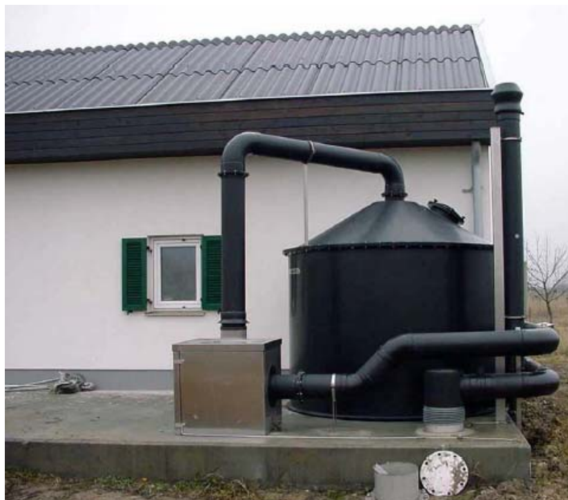
Abbildung 63: Biofilteranlage Sammler Nord, RHV NSW
